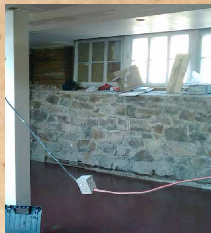
Les travaux ont permis de dégager la fondation épaisse de 1 mètre en granite rose qui soutien le bâtiment.
