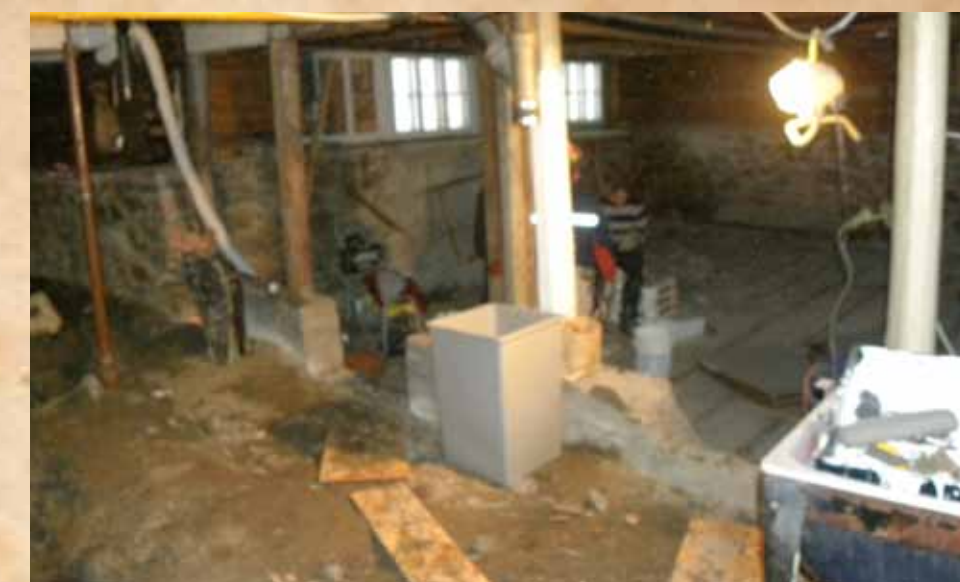
Travaux à l'endroit où se trouve actuellement le Bar à pitons : tout était à faire!
